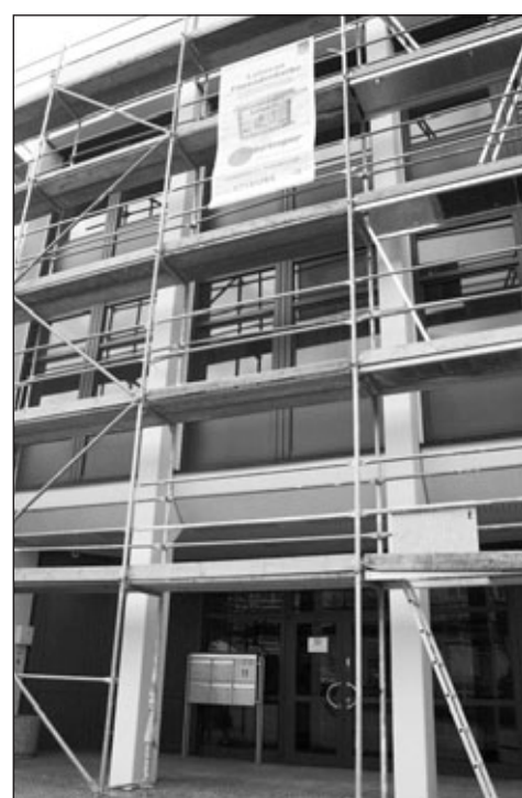
Derzeit wird das Gebäude Gewerbestraße 11, in der die neue Energieagentur Rems-Murr eröffnet wurde, gegen Wärmeverluste gedämmt.
