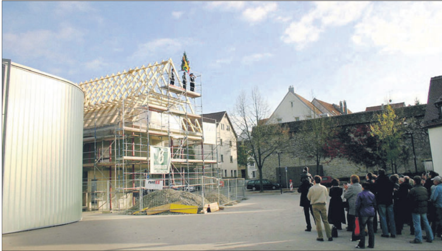
„Kernig in der Erd“ steht der Rohbau für die neue Hackermühle – das Richtfest ist gefeiert.
