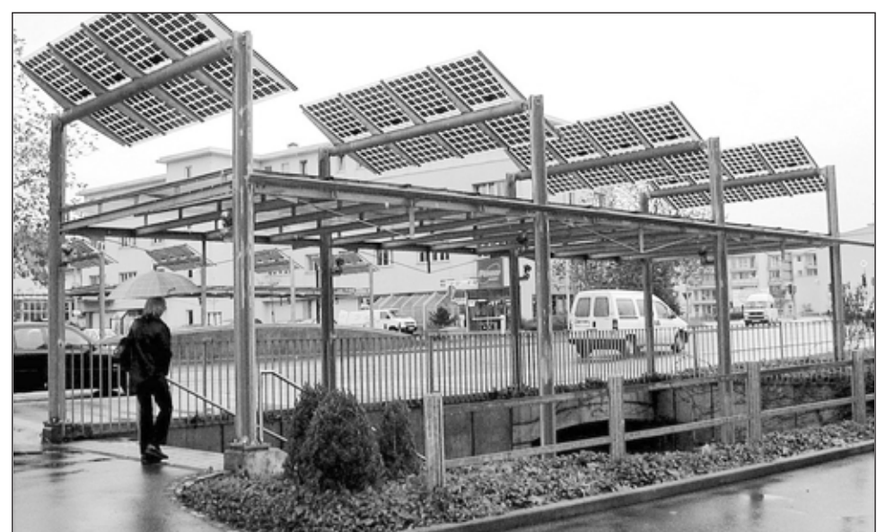
Schon seit 2001 „sammelt“ die Fotovoltaik-Anlage vor dem Bürgerzentrum Strom und Wärme. Im Zusammenhang mit der „Solaroffensive“ hatte die Stadt Waiblingen schon etliche Dächer auf städtischen Gebäuden für Solarstrom-Anlagen zur Verfügung gestellt. Um aber noch mehr Nachfragen aus der Bürgerschaft, die solche Anlagen installieren will, positiv beantworten zu können, bittet die Stadt Unternehmen um Unterstützung, Firmendächer zu vermieten. Foto: Öffentlichkeitsarbeit der Stadt Waiblingen
